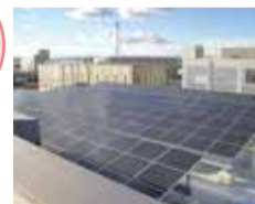
太陽電池パネル
