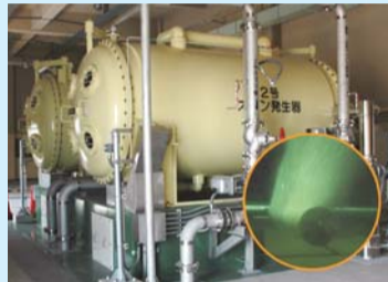
オゾン発生器とオゾン接触池(円内)
