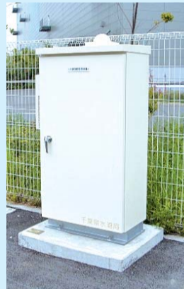
水質自動監視装置
