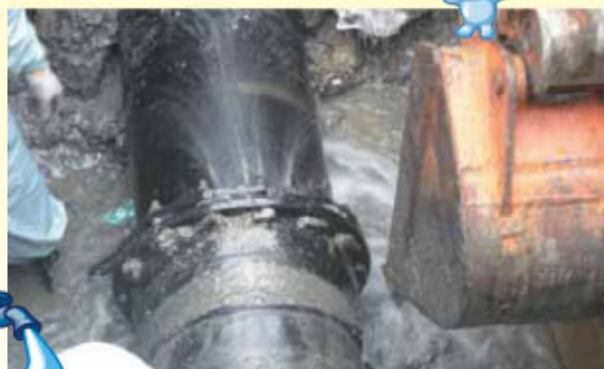
▲漏水により水が噴き出す水道管
