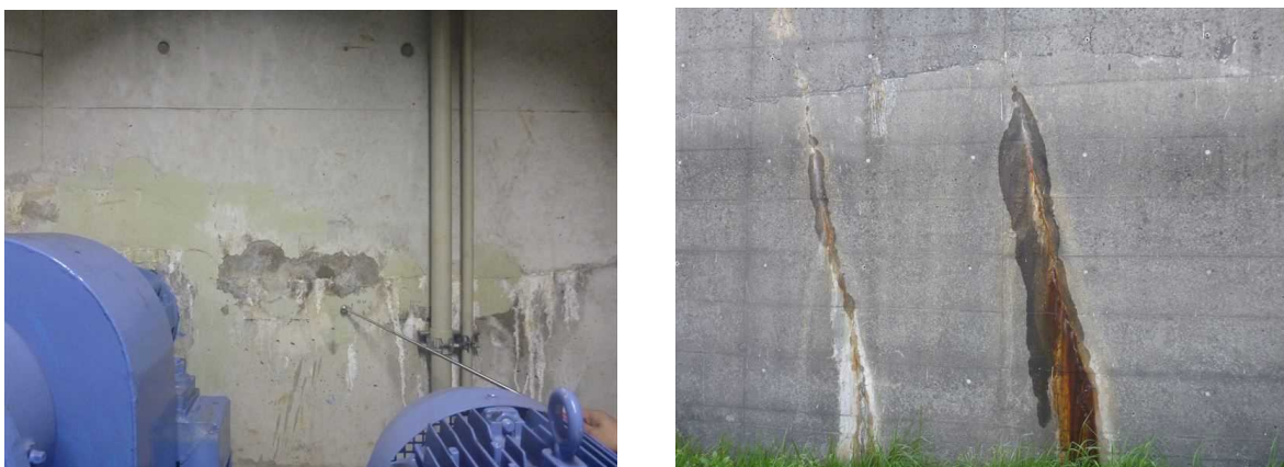
図-2.22 土木施設の劣化状況
