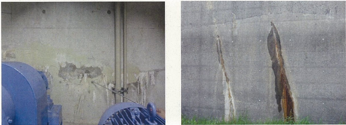
図-2.4 土木施設の劣化状況
