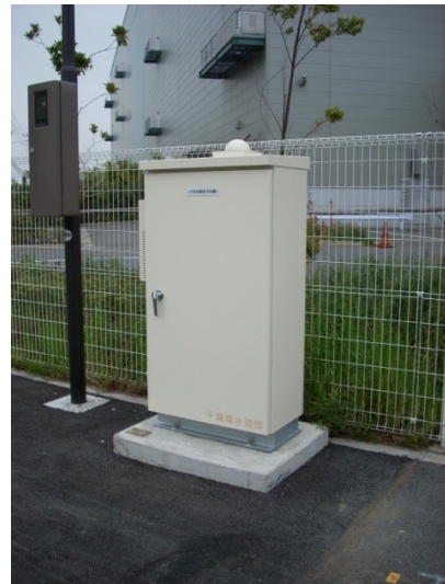
写真.5 水道自動監視装置
