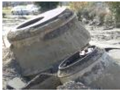
液状化で破壊した耐震性貯水槽
