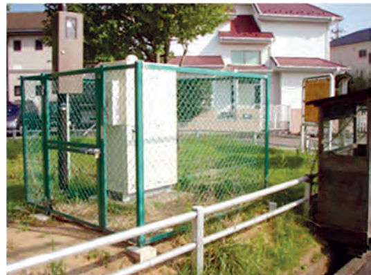
図V—6 水質自動監視装置
