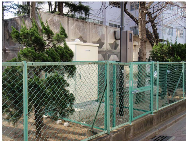
図 1-1-1 水質自動監視装置の外観
