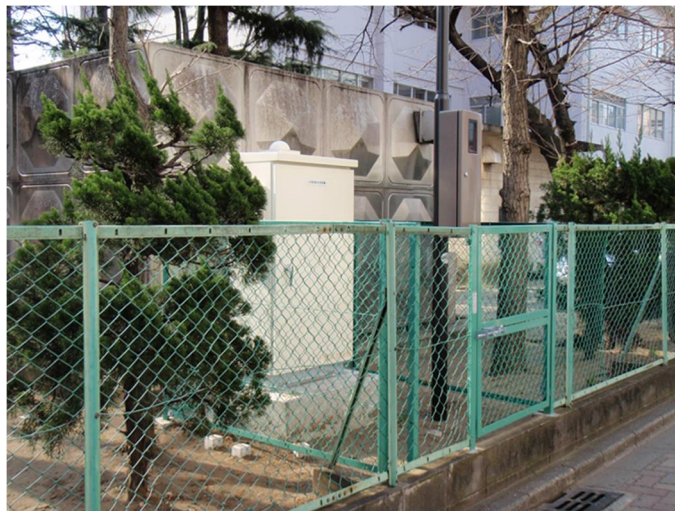
図 1-1-1 水質自動監視装置の外観
