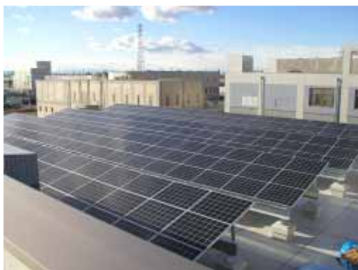
太陽光発電施設(送配水ポンプ棟屋上)
