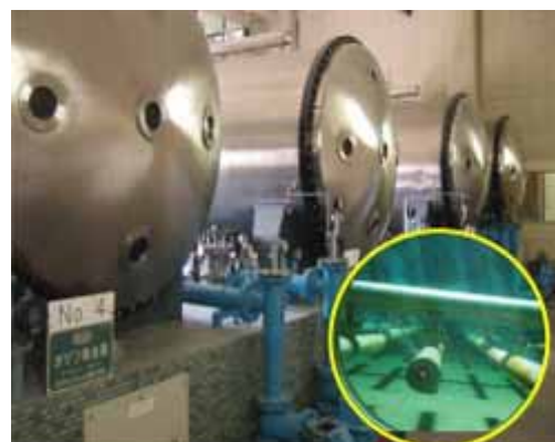
オゾン発生器とオゾン接触池(柏井浄水場)
