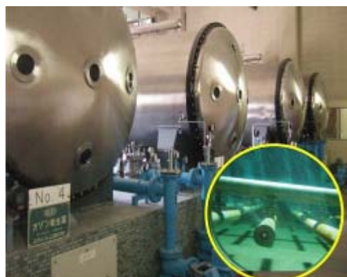
▲オゾン発生器とオゾン接触池
