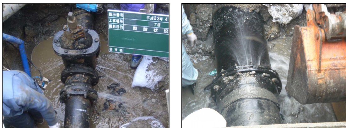
図7 東日本大震災の液状化で漏水した管路
