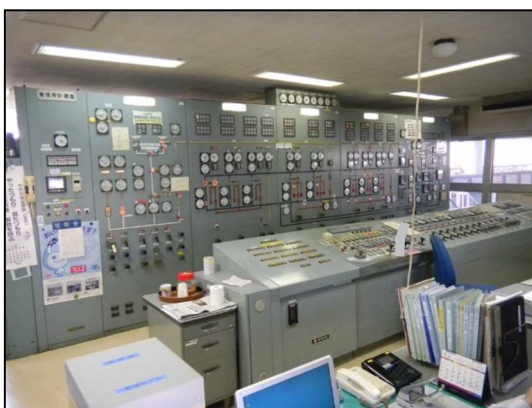
図8 監視設備（更新前）
