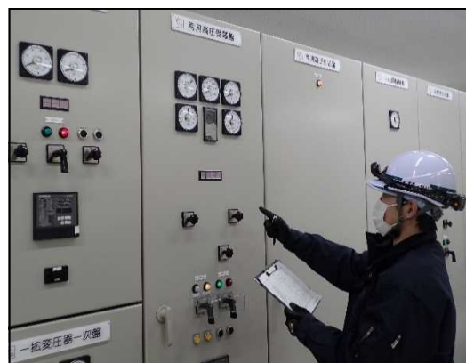
図9 職員による設備点検
