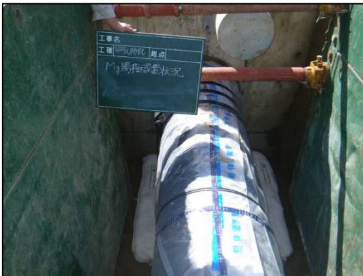
図 16 電気防食設置状況
