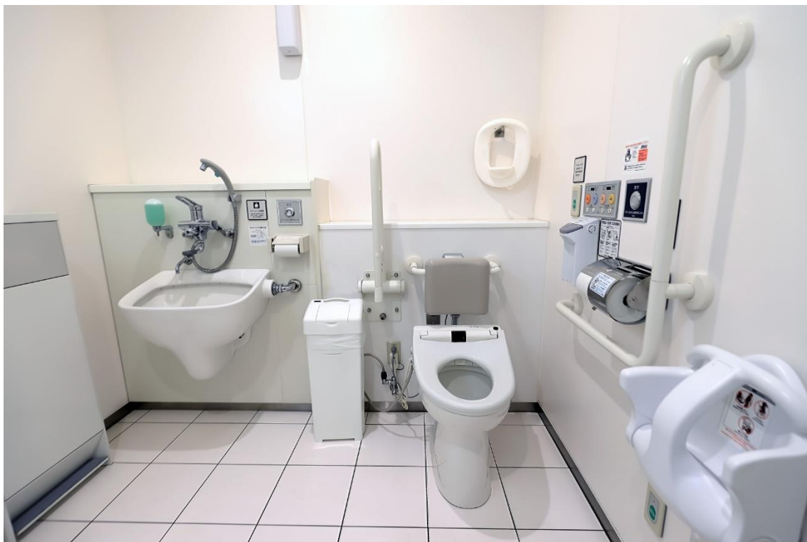
写真：バリアフリートイレの例
