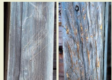
屋根裏に棲みつき、頻繁に登り降りすることでできた爪跡の傷
