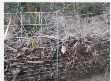
土砂堆積による 高さ不足・破損
