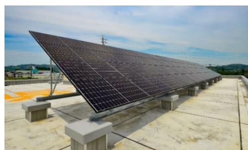
太陽光パネル
