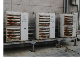
腐食が目立つ空調室外機
