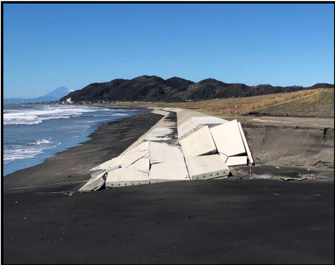
(防潮堤の被災)
