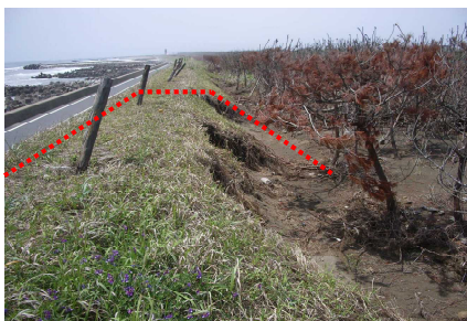
土塁の裏法損傷（旭市三川）
