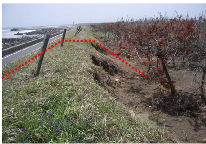
土塁の裏法損傷（旭市三川）
