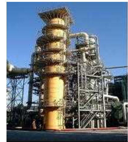
水素化脱硫装置
