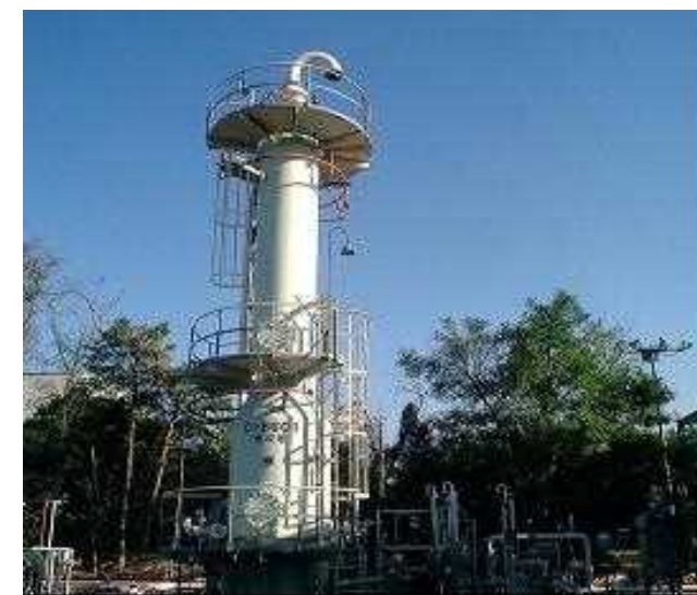
炭化水素ベーパー回収装置
