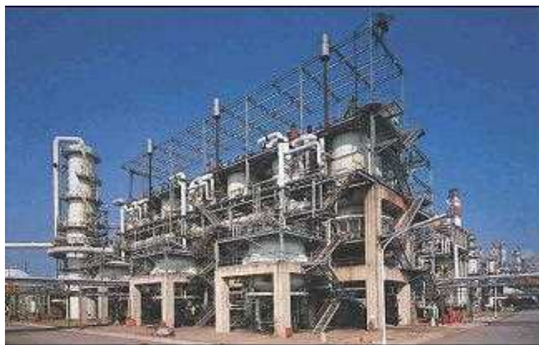
ユリカ減圧残油熱分解装置
