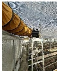
外気導入 ダクトファン
