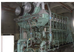
柏井浄水場自家発電設備
