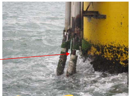
海底ケーブル防護用 可とうステンレス管のずれ落ち
