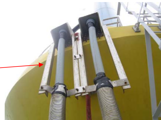
海底ケーブル固定用鋼材変形
