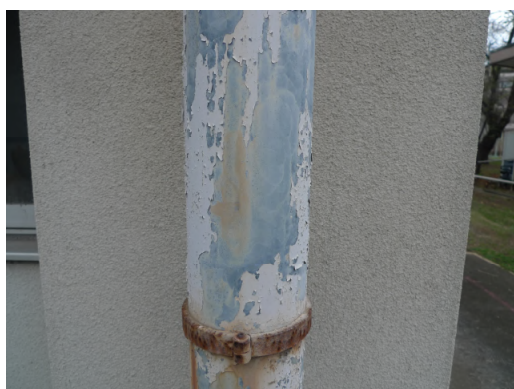
写真 1 塗装の剥がれたパイプ
