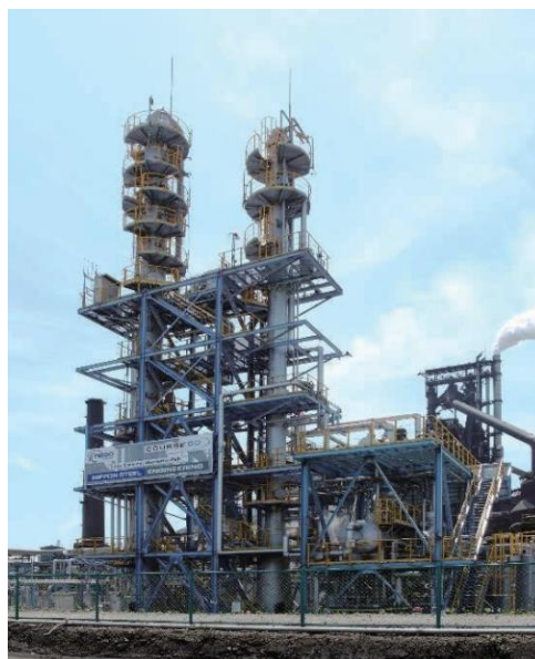
(2)CO 2 分離・回収設備
