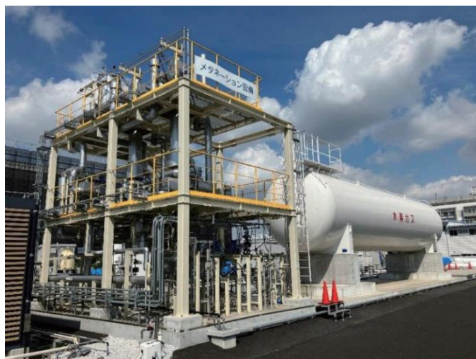
写真 4-2-5 メタネーション施設
