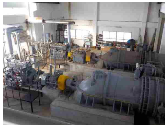
長寿命化対策を実施した農業水利施設（排水機場）
