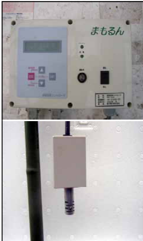
図1 結露センサー付き暖房機制御装置 注) 上; 暖房機制御装置 下; 結露センサー
