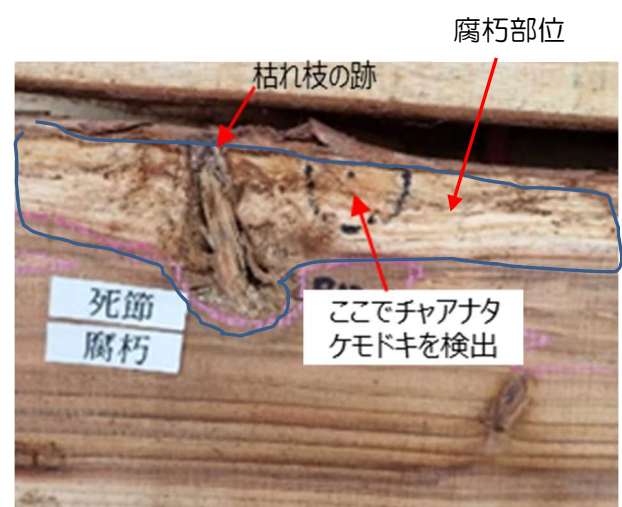
枯れ枝の跡から腐朽が進行している様子
