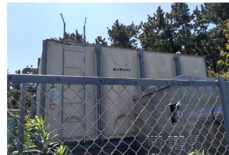
(屋外プール市水受水槽)
