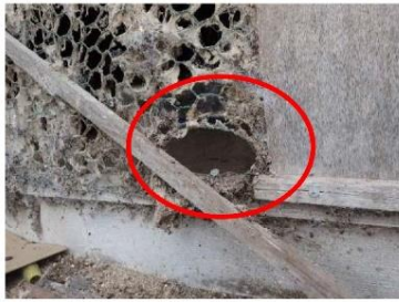
金網や防鳥ネット等の 破損
