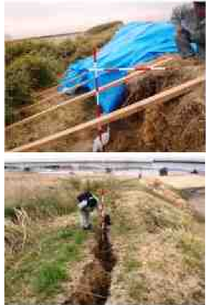
東日本大震災による 堤防の被災状況
