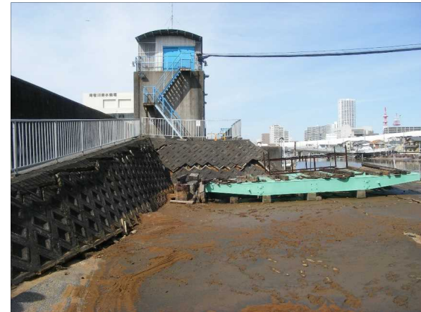
海老川水門 取付護岸の破壊
