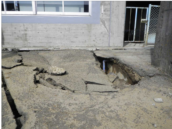
船橋排水機場 舗装の陥没
