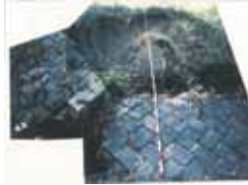
河床低下による護岸の破損
