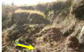
溪岸の崩壊状況
