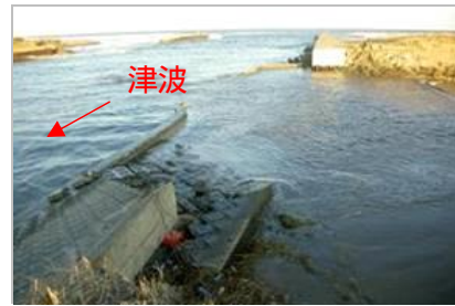
津波による堤防決壊(二)木戸川
