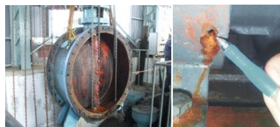
劣化した部品の例
