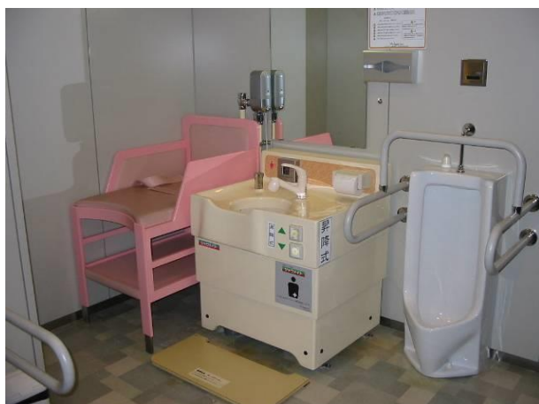
県庁内の多機能トイレ (オストメイトにも対応)
