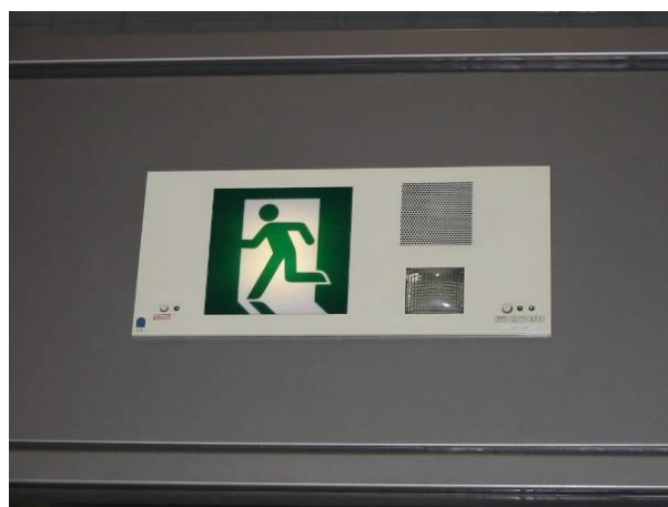
避難誘導の表示（左のピクトグラム）、非常時に点滅するフラッシュランプ（右下）、非常放送用のスピーカー（右上）により、複数の方法で緊急情報を提供している例
