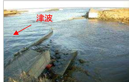
津波による堤防決壊（二）木戸川
