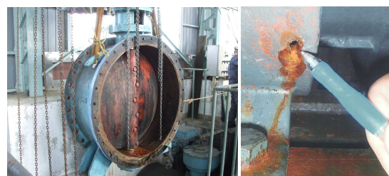
劣化した部品の例
