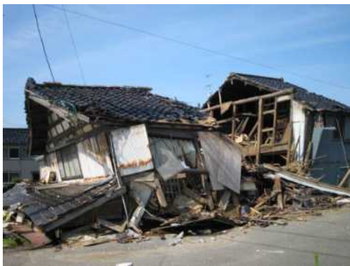
新潟県中越沖地震で倒壊した建築物
