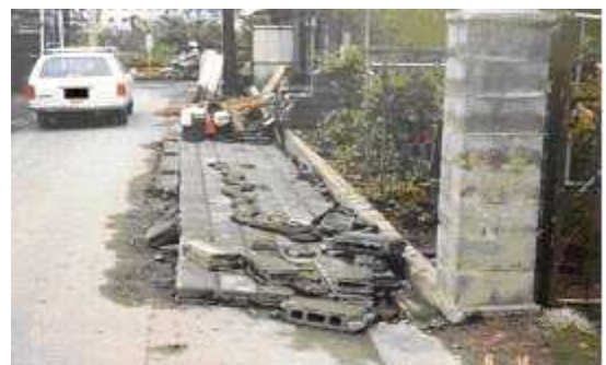
コンクリートブロック塀倒壊例
