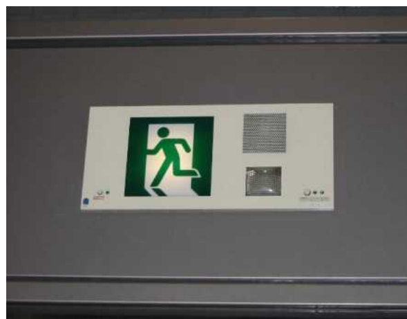
避難誘導の表示(左のピクトグラム)と非常時に点滅するフラッシュランプ(右下)と、非常放送用のスピーカー(右上)により、複数の方法で緊急情報を提供している例
