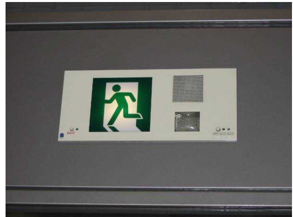
避難誘導の表示（左のピクトグラム）、非常時に点滅するフラッシュランプ（右下）、非常放送用のスピーカー（右上）により、複数の方法で緊急情報を提供している例
