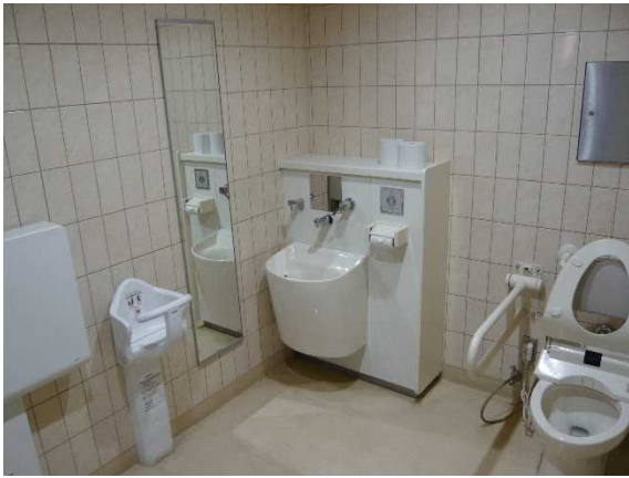
県庁内の多機能トイレ (オストメイト※にも対応)
