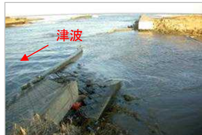
津波による堤防決壊（二）木戸川
