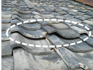
瓦に浮き上がりが生じている
