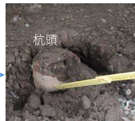
杭頭と基礎が離れた
