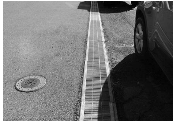
浸水対策として設置したグレーチング
