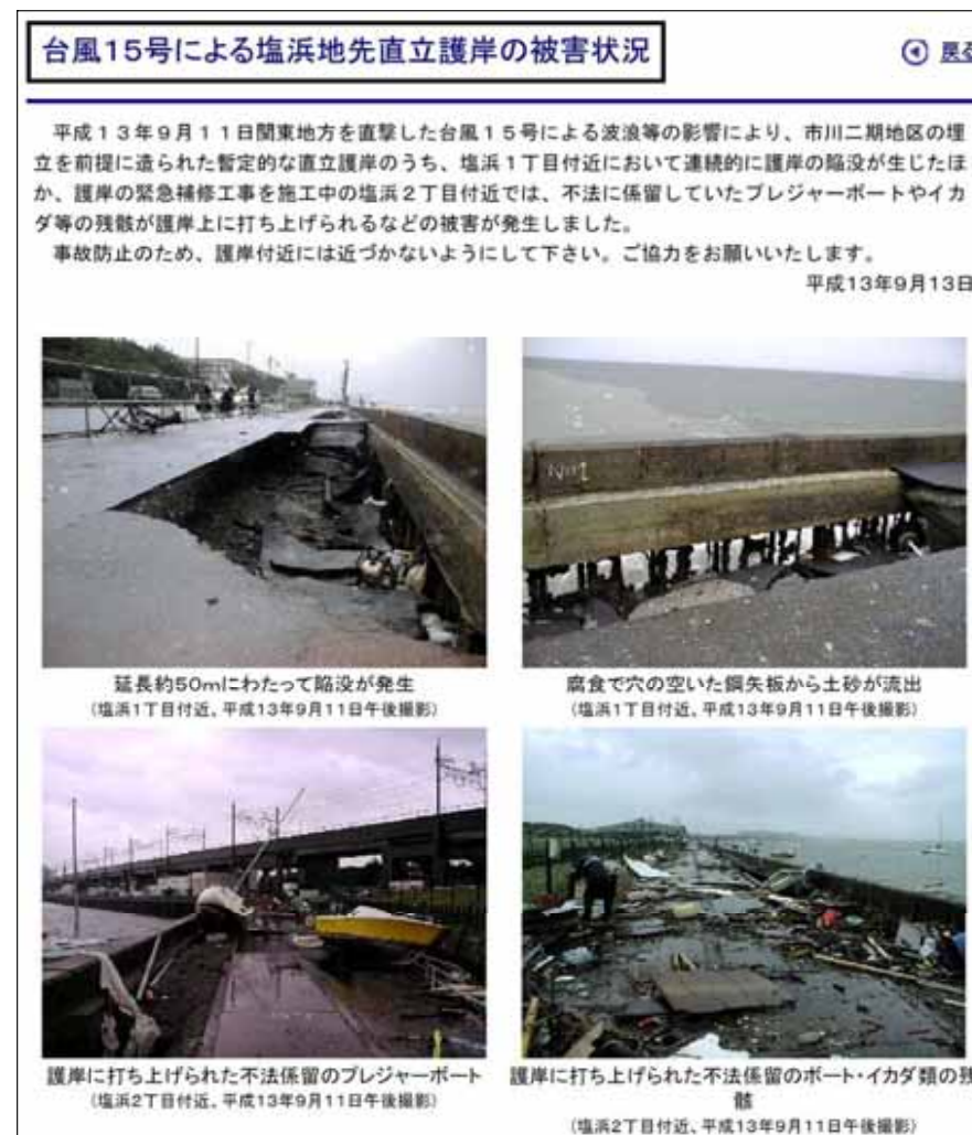
図9 2001年(平成13年9月)台風15号による被害状況 ※3
