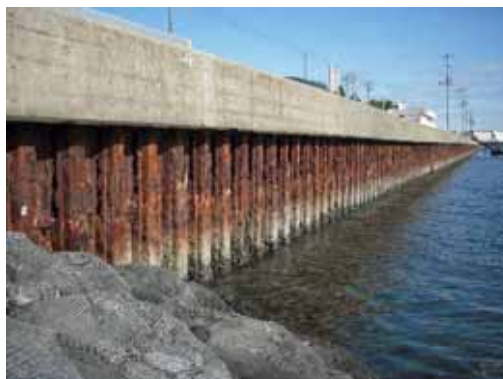
鋼矢板が腐食し老朽化が著しい現況護岸 (手前の袋詰めネットは応急的に補強したもの)
