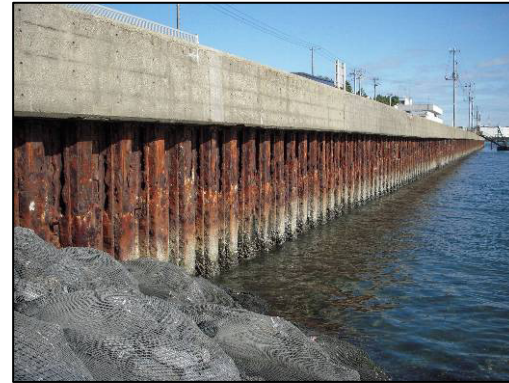
鋼矢板が腐食し老朽化が著しい現況護岸 (手前の袋詰めネットは応急的な補強)
