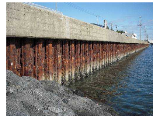
鋼矢板の腐食等により老朽化が著しい塩浜 1 丁目護岸
