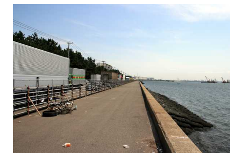
塩浜 1 丁目護岸部の現況 現在は倒壊の恐れがあるため護岸部は柵が設置され立ち入り禁止となっている。
