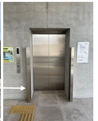
ホール1Fのエレベーター (止水板が設置できる構造)
