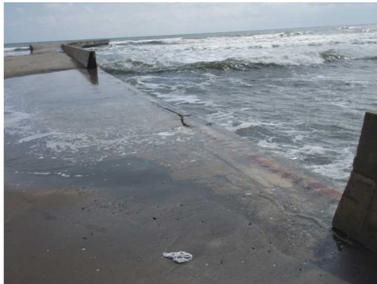
■ 河口左岸の護岸堤防倒壊
